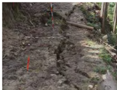
写真. 7 作業道の路肩亀裂
