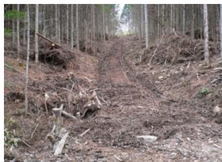
写真. 2 作業道からの土砂流出要因
