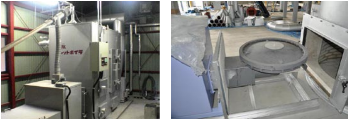
写真 7.4 国産ペレット焚き温水ボイラーとバーナーの構造 (二光エンジニアリング)
