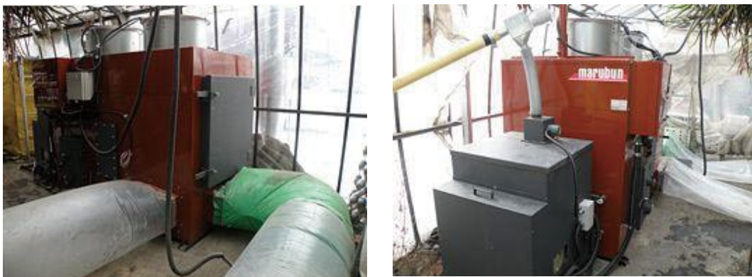
写真 7.3 国産ペレット焚き農業用温風ボイラー (株丸文製作所)
